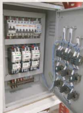
Wiring เก็บสายต่างๆ
